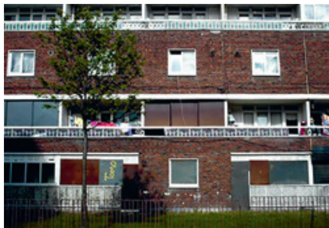
Abb. 46: Leerstehende Wohnungen in der Anlage Dominick Street West © City Architects Division
